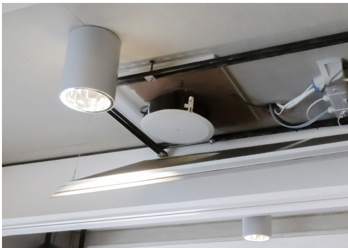
Installation eines AD-C6T-LP
